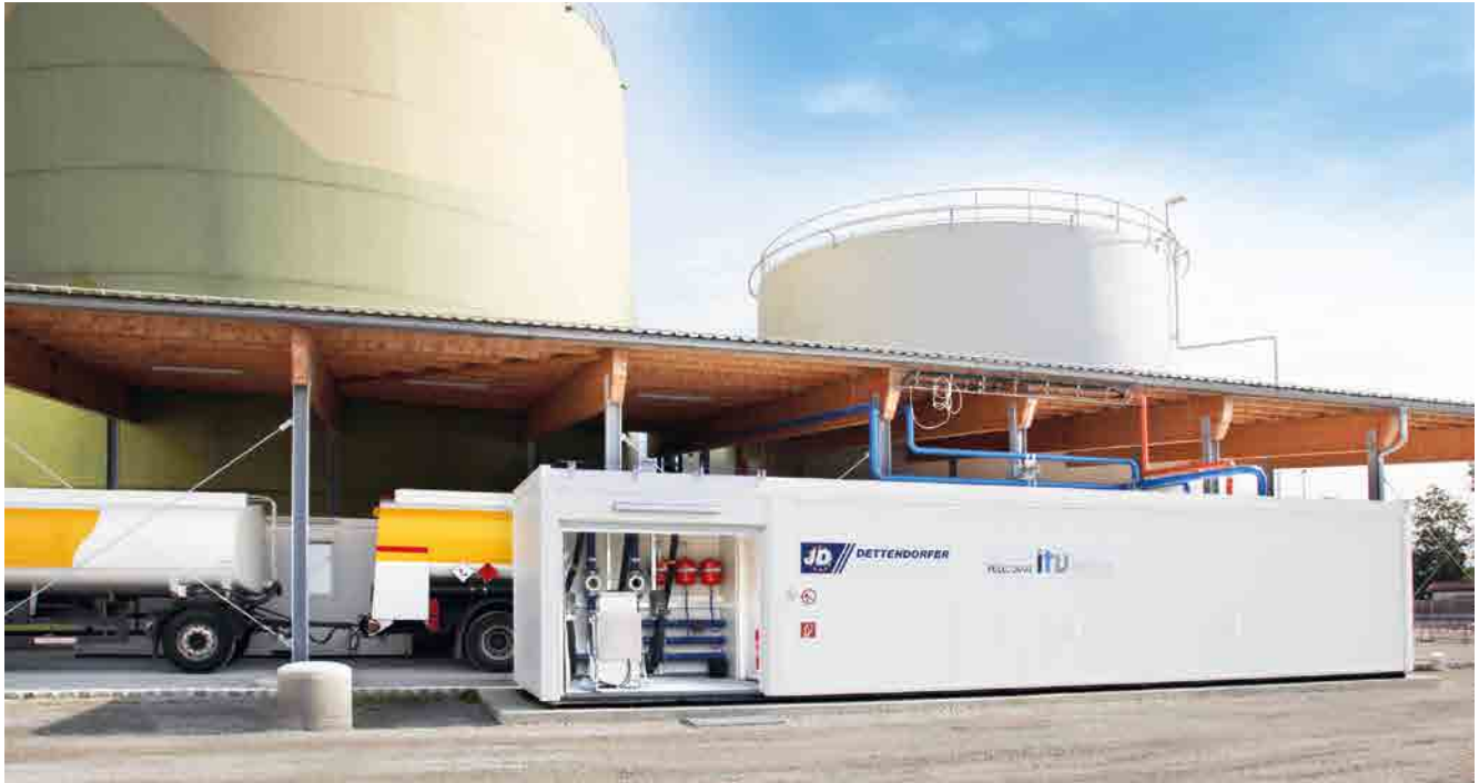
Tanklager Kiefersfelden mit Füllcomat® im Vordergrund (hier noch aus der Bauphase)
